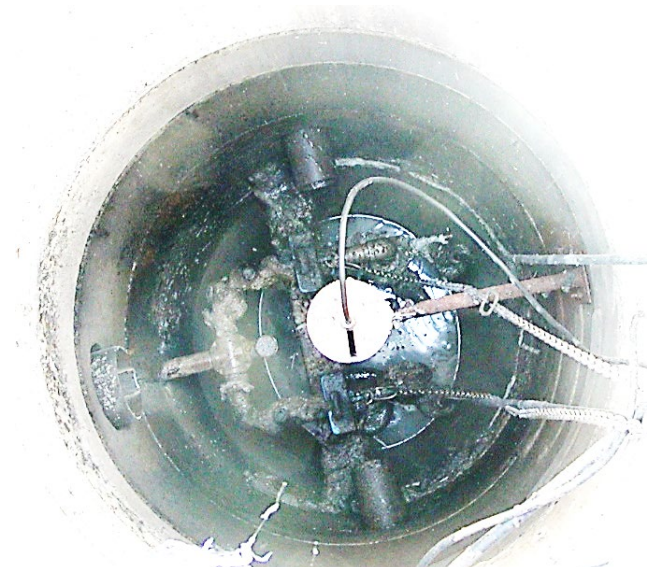
Billede 6: Sump med 3 tilløb over vandspejlet uden prelplader
