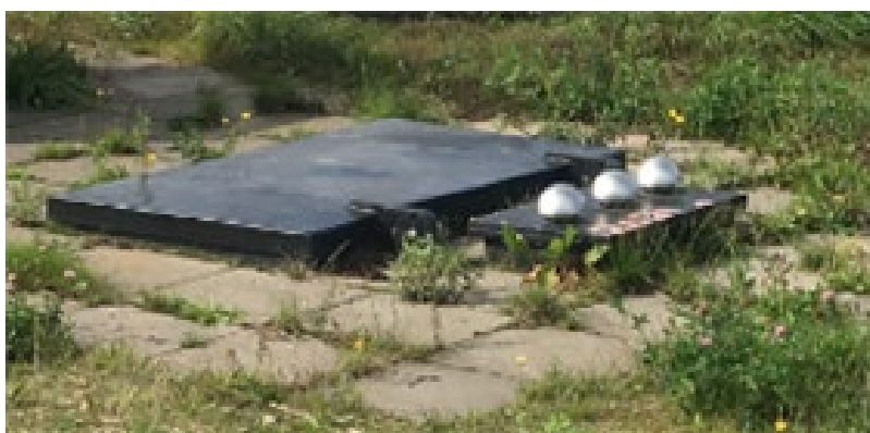
Billede 11: Overfaldet PE-dæksel over svovlbrintebelastet sump
