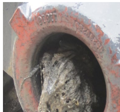
Billede 4: Sammenfiltret fibrøst materiale i pumpe
