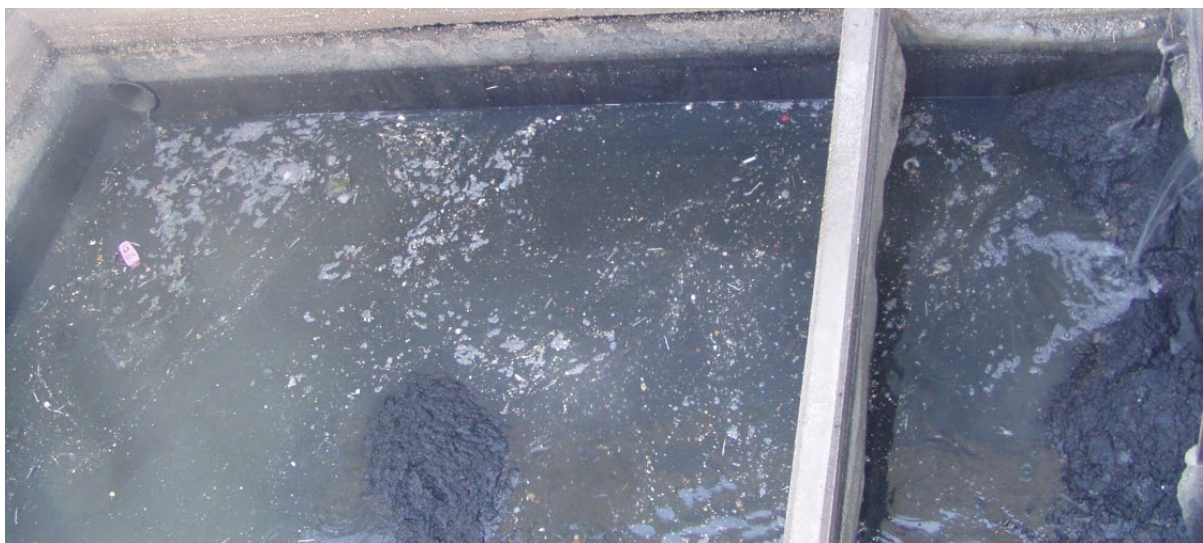
Billede 3: Pumpesump med stagnationszoner "døde"-zoner, hvor sedimentopbygning foregår
