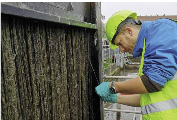
Fremtidens renselanlæg er kompakte, komplekse anlæg styret af computerbaserede algoritmer. Her ses MABR-pilotanlægget på Ejby Mølle renselanlæg, hvor "tråde" er bærelagene for bakterier og membraner til iltoverførsel. Foto: Ivan Vølund, VandCenter Syd.
